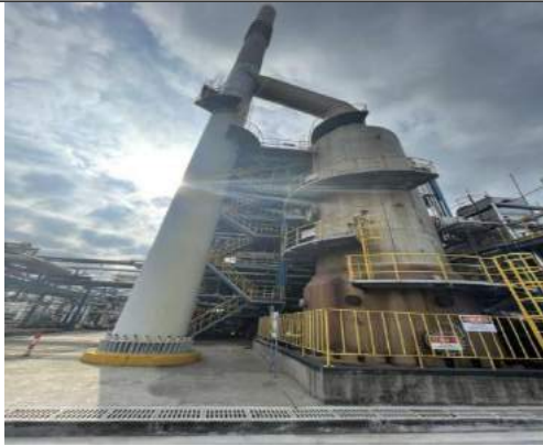
废气处理设施
